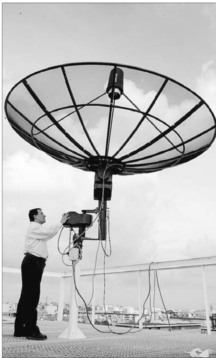
Un técnico del departamento controla la antena instalada. / JOSÉ JORDÁN
